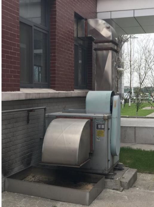
图 8.2-1 沿线收费站食堂油烟净化装置现场照片
