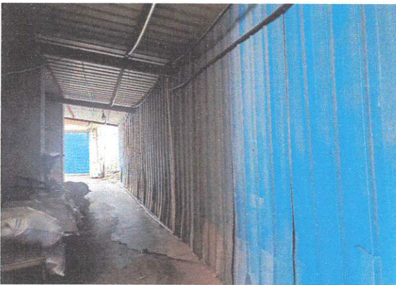
山观粮管所（西街124号）办公楼西南侧搭建
